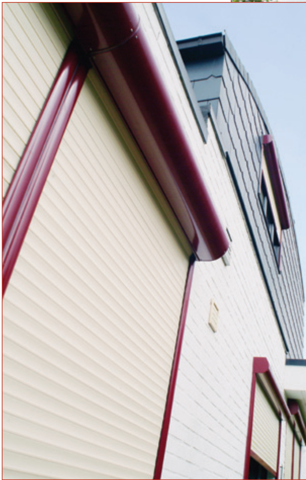
VOLETS ROULANTS EXTERIEURS RENOVATION
